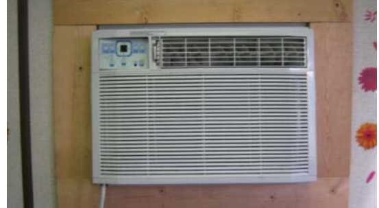
Frigidaire A/C unit
