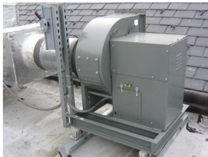
Rooftop exhaust fan
