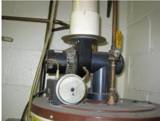
AO Smith heater automatic flue damper
