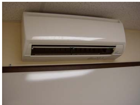
Mini heat split in Interrogation room
