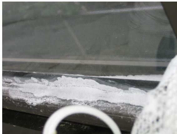
Tenant window showing moisture
